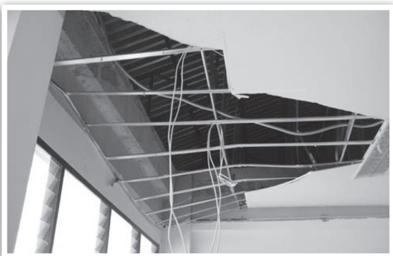
รูปที่ 10 สภาพฝ้าเพดานห้องเรียนใกล้กับโถงบันไดทิศใต้
