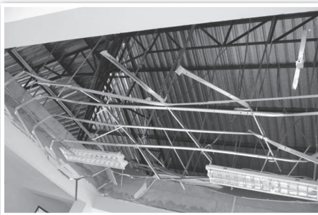
รูปที่ 9 สภาพฝ้าเพดานบริเวณช่องบันไดชั้น 3 ที่พังเสียหายอย่างหนัก
