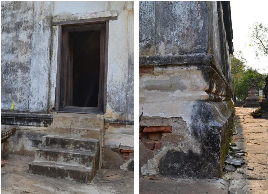
ภาพที่ 4.11 บันไดและฐานอาคารของสิมวัดโคกพระ
