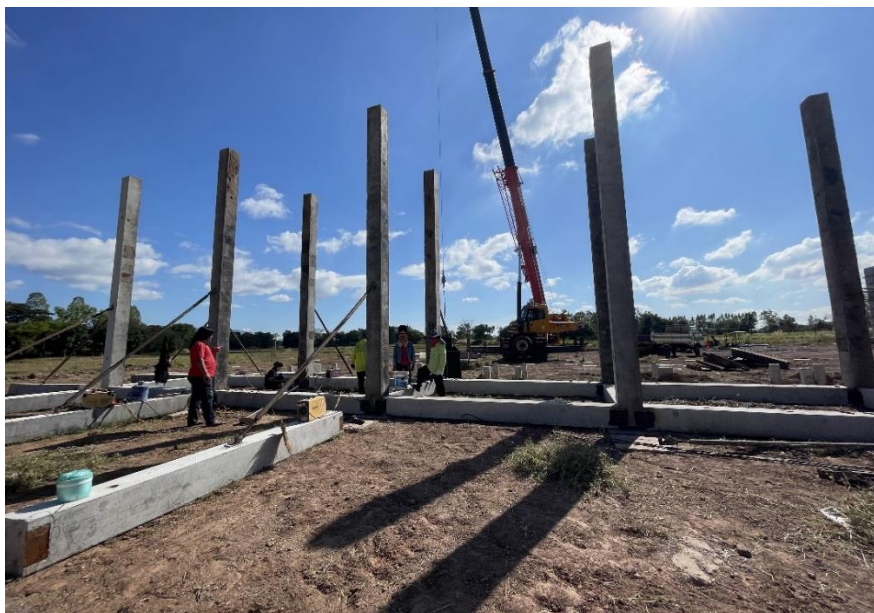
ภาพที่ 4.46 ตรวจสอบคืบหน้าโรงงานน้ำแข็ง วันที่ 10 ธันวาคม 2565
