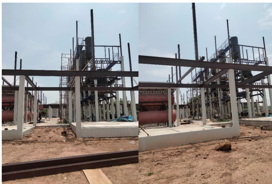
ภาพที่ 4.55 ตรวจสอบความคืบหน้าโรงงานน้ำแข็ง วันที่ 24 เมษายน 2566
