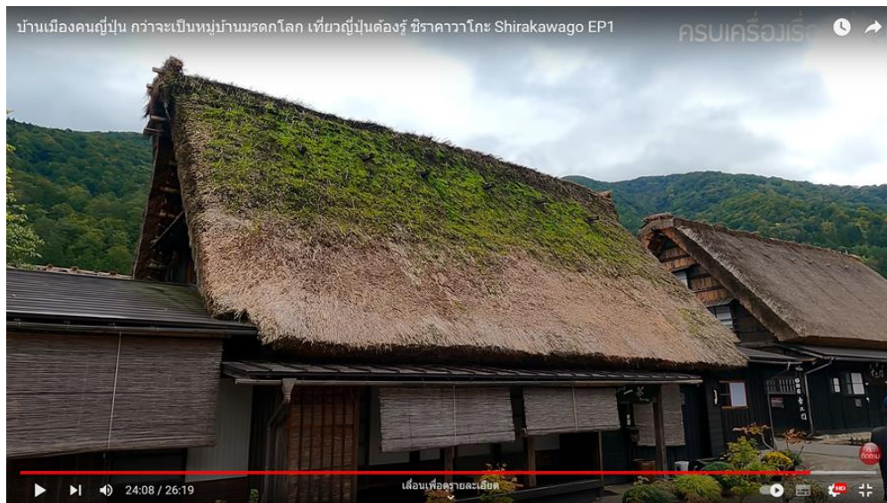
ภาพที่ 3.4 ความแตกต่างของหลังคาที่มีการซ่อมแซม
