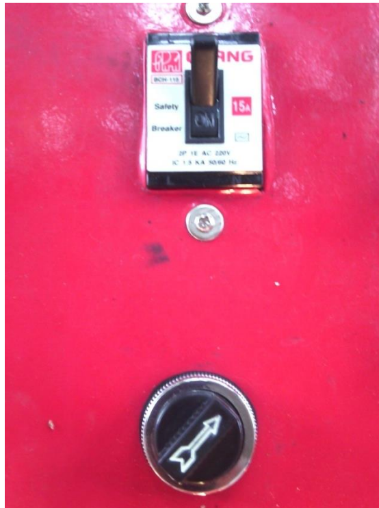
ภาพที่ 3.69 แสดงการใช้เบรกเกอร์ขนาด 15 แอมป์ และสวิตช์ปรับค่าได้ควบคุมไฟฟ้ากระแสตรง
