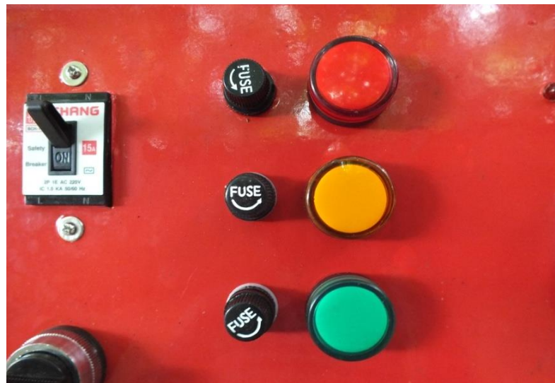
ภาพที่ 3.39 แสดงการติดตั้งอุปกรณ์ที่ใช้ตรวจวัดไฟฟ้ากระแสตรง
