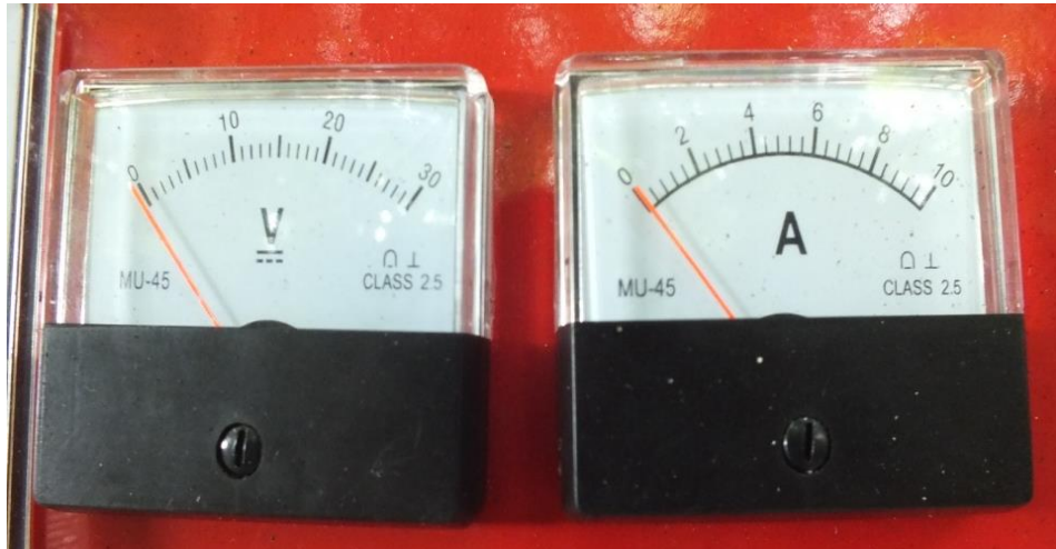
ภาพที่ 3.38 แสดงการติดตั้งอุปกรณ์ที่ใช้ตรวจวัดไฟฟ้ากระแสตรง
