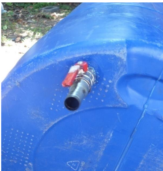
ภาพที่ 3.24 แสดงการเจาะรูและติดตั้งวาล์วขนาด 1.905 เซนติเมตร เข้ากับก้นถังขนาด 200 ลิตร
