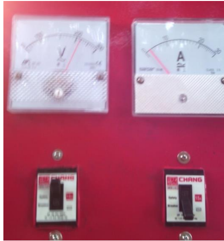
ภาพที่ 3.63 แสดงการทดสอบวงจรไฟฟ้ากระแสสลับโดยใช้เบรกเกอร์ที่อยู่ด้านซ้ายมือควบคุม
