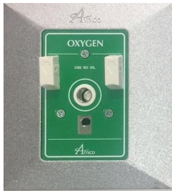
รูปที่ 9 ออกซิเจนจาก central supply ที่ส่งมาตาม pipeline ที่มา : http://www.totalmed.co.th
