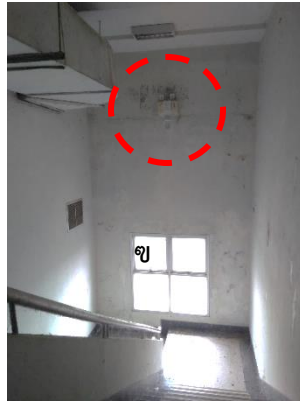
ภาพที่ 1 ไฟฉุกเฉินที่บริเวณชั้น 6
