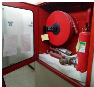
ภาพที่ 4 ภายในตู้เก็บอุปกรณ์ดับเพลิง
