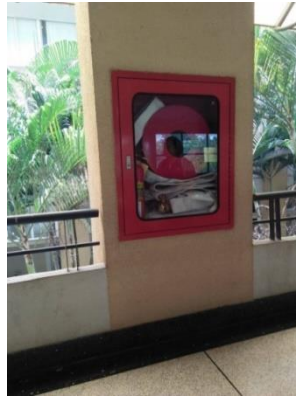
ภาพที่ 3 ตู้เก็บอุปกรณ์ดับเพลิง
