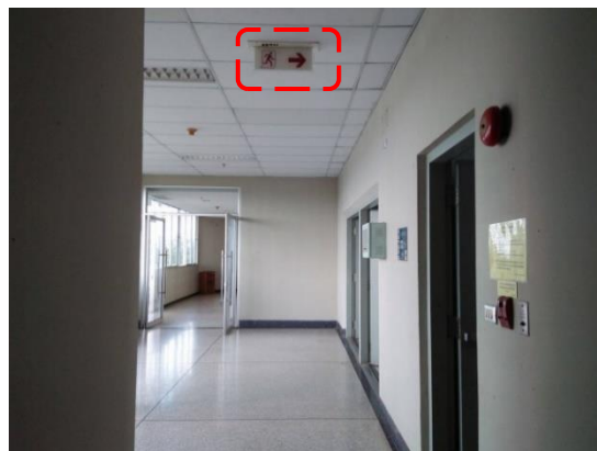
ภาพที่ 6ป้ายทางหนีไฟบริเวณชั้น 5
