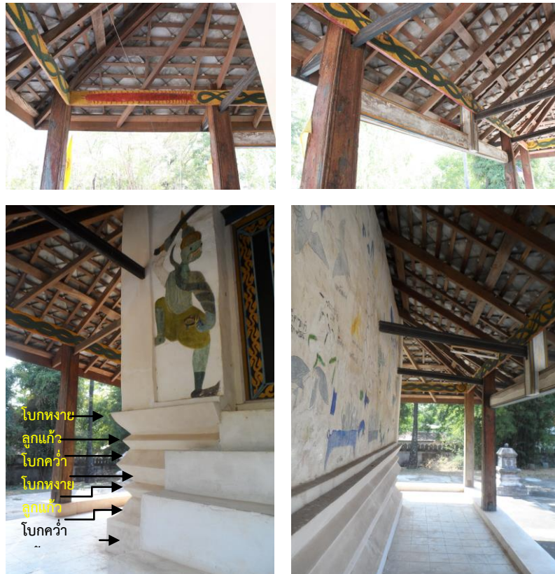
ภาพที่ 4.9 โครงสร้างเสาและโครงหลังคาของสิมวัดบรมคางคา
